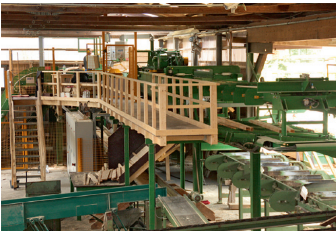
Neuer automatischer Besäumer ASM 200 von H.I.T. wurde zum Jahreswechsel 2010/11 bei Lakebrink installiert
